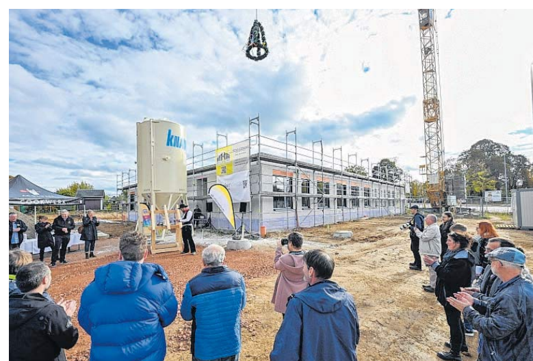
Richtfest wurde an der Ecke Augsburgers Straße/Reichenhainer Straße für das Gebäude des Kinder- und Jugendnotdienstes gefeiert. FOTO: ANDREAS SEIDEL
